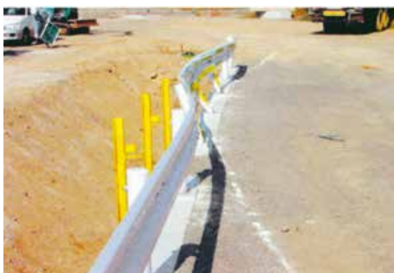
衝突後の状況（直接基礎上）
