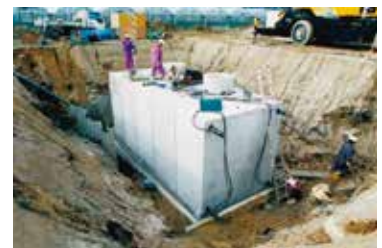
PC鋼より線による緊張 緊張作業後、目地部に止水加工を施します。
