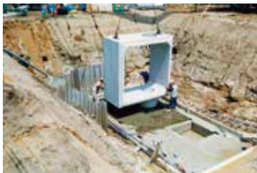
cブロック据付け ピット部の基礎にはモルタルを充填します。
